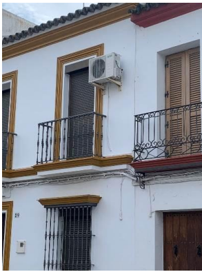
Otro de los aspectos que afecta significativamente el paisaje urbano y que se deberá revertir es la presencia de antenas y aparatos de aire acondicionado en las fachadas de viales históricos, especialmente, y que se deberá revertir. ©V+M
