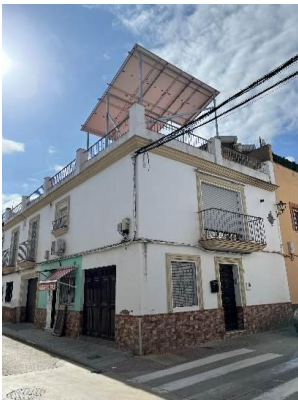
En un espacio tan significativo como es la esquina entre las calles de En medio y de Sevilla, nos encontramos con la presencia de cableado que atraviesa ambas calles, junto a la presencia, también de cajas de conexión y nuevo grapado desordenado de cables en las fachadas. © V+M
